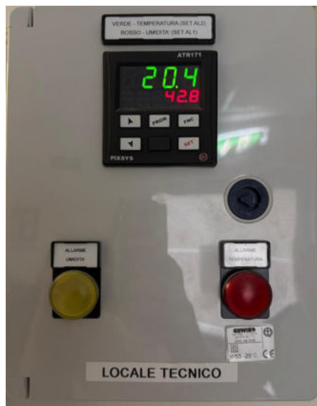
Figura 2: Centralina di controllo temperatura ed umidità della sala tecnica.
