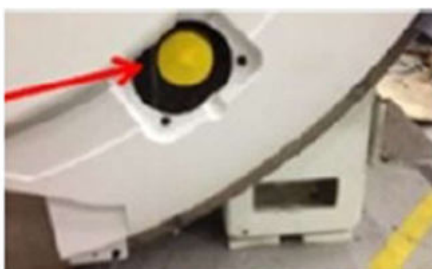
Figura 3.: Presa del vuoto della copertura del magnete con coperchio antipolvere.
