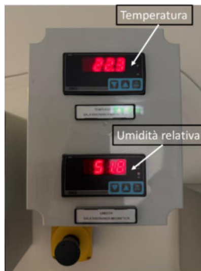
Figura 1: Centralina di controllo temperatura, umidità e percentuale di ossigeno della sala RM.
