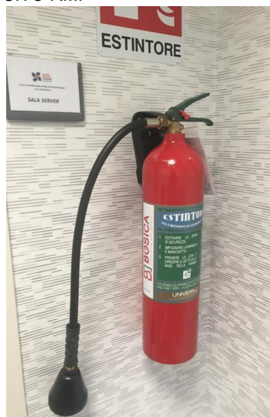
Figura: estintore all'interno del sito RM
