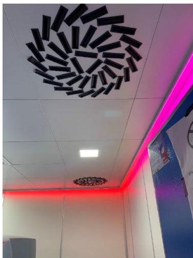
Figura: bocchette di aerazione di mandata
